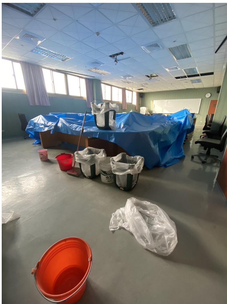
第二會議室漏水及天花板掉落破損狀況
