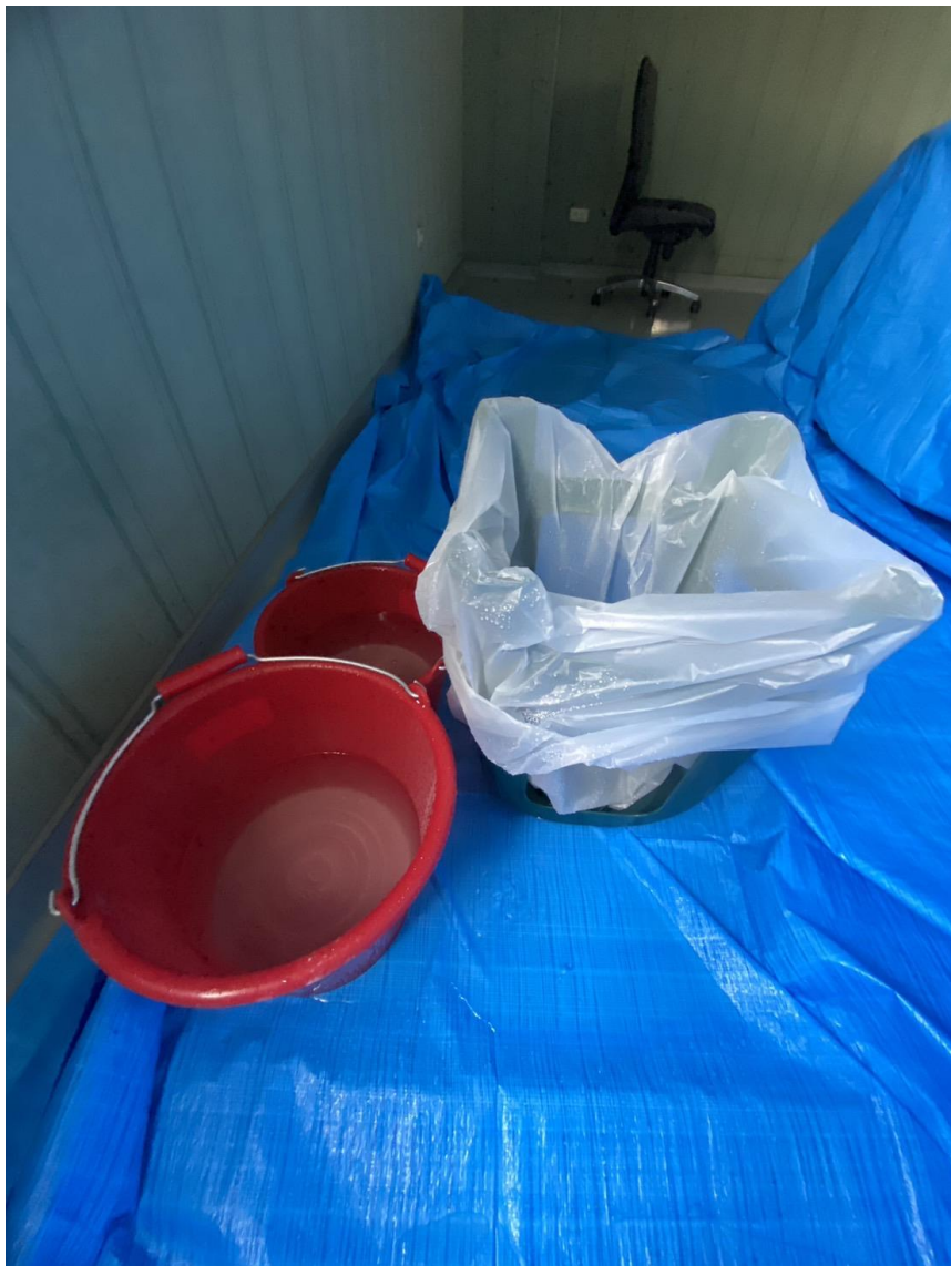
第三會議室漏水狀況
